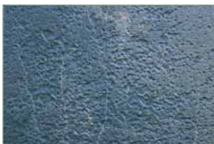
图4 泵轮汽蚀损伤的特写
